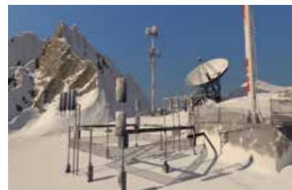
Installazioni a bassissima temperatura
